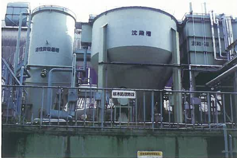
排水処理設備
